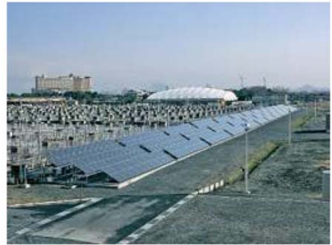
図 3-3-26. 湖南中部浄化センターにおける太陽光発電
